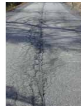
Abbildung 15: Schadensbild Frostschaden (besonders Längsrisse)
