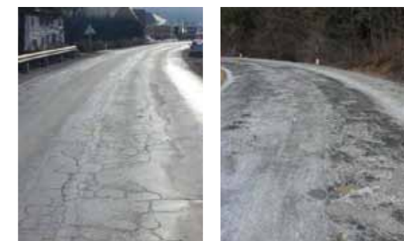
Abbildung 18: Schadensbilder „Lastfall Frühjahr“
