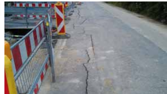
Abb. 8 Schadensbild durch unsachgemäße Pölzung
