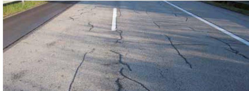
Abbildung 14: Netzzrisse auf der Fahrbahn
