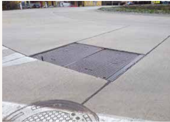
Abb. 39 Typisches Schadensbild bei rechteckigen Systemen
