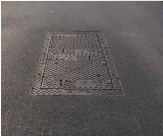
Abb. 44 fertig eingebautes System
