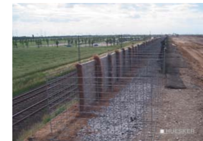
Ungefüllte Gabionenreihe mit Geogitterrückverhängung
