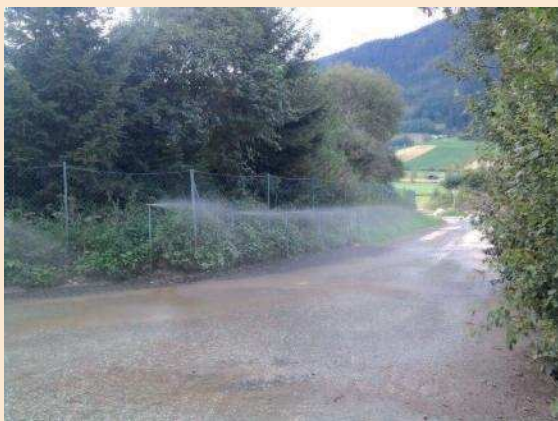
Abbildung 5: Entstaubung von Straße (Quelle: Firma IAG Produkt DLS - Düsenleitungssystem)
