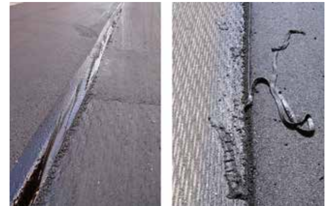
li.o.: Maschinelle Beschichtung welche überfahren wurde re.o.: Fugenband welches überfahren wurde
